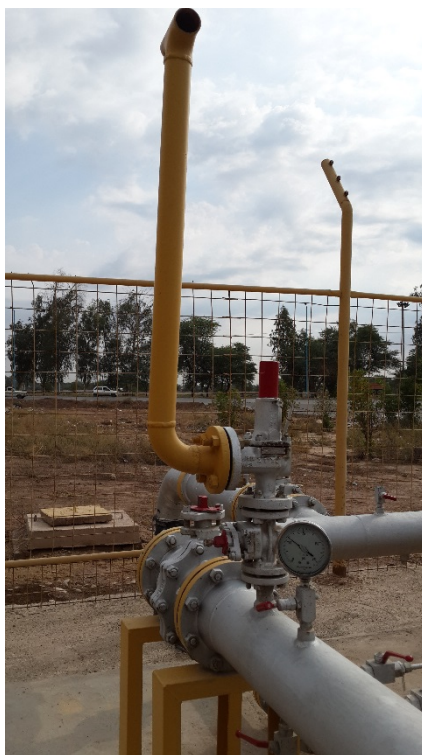
شکل ۱-۳: شیر تخلیه در ایستگاه تقلیل فشار
