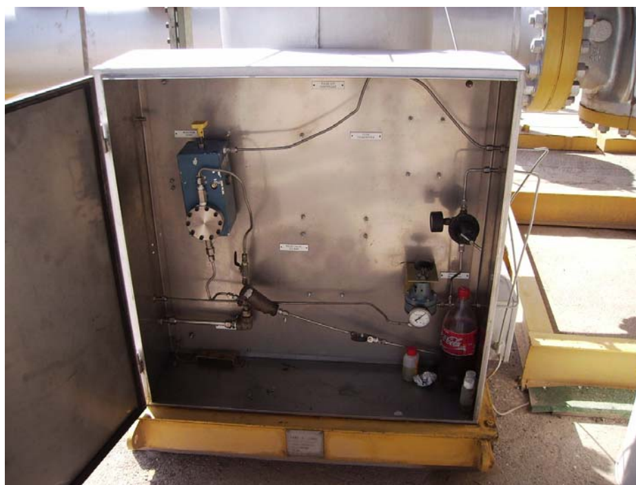
شکل ۲۴.۴: سیستم بوزنی پالسی نصب شده در CGS شرق
