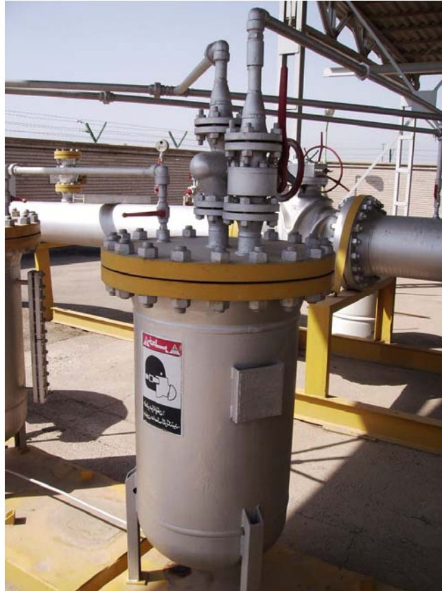
شکل ۱۸.۴: نمونه‌ای از سیستم کنارگذر نصب شده در CGS شرق
